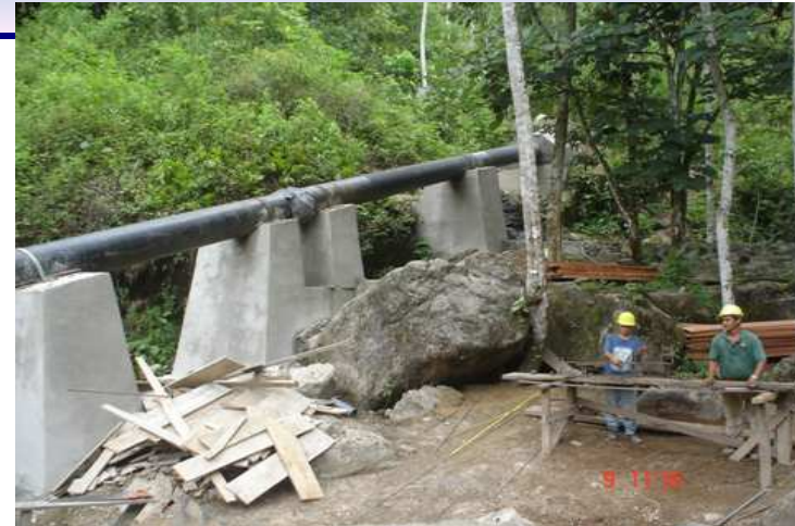
Tubería forzada El Bote
